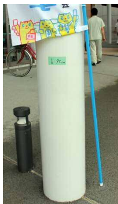
庁舎入口は 95 cm 浸水
