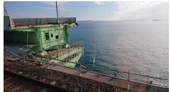
2018. 9. 23 関空橋の破損状況
